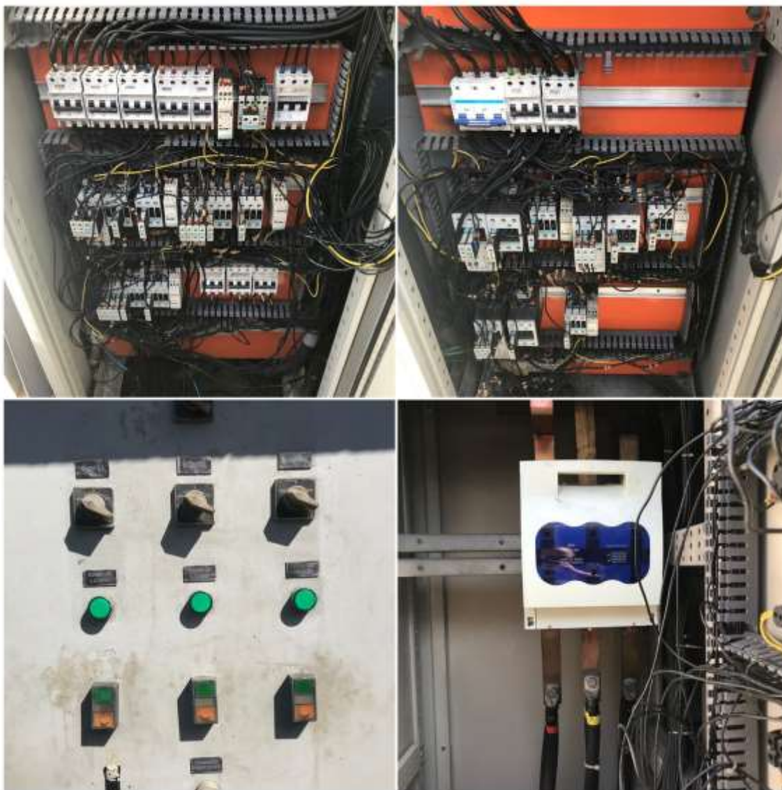
Figuras 8, 9, 10 e 11 – Quadros Elétricos
