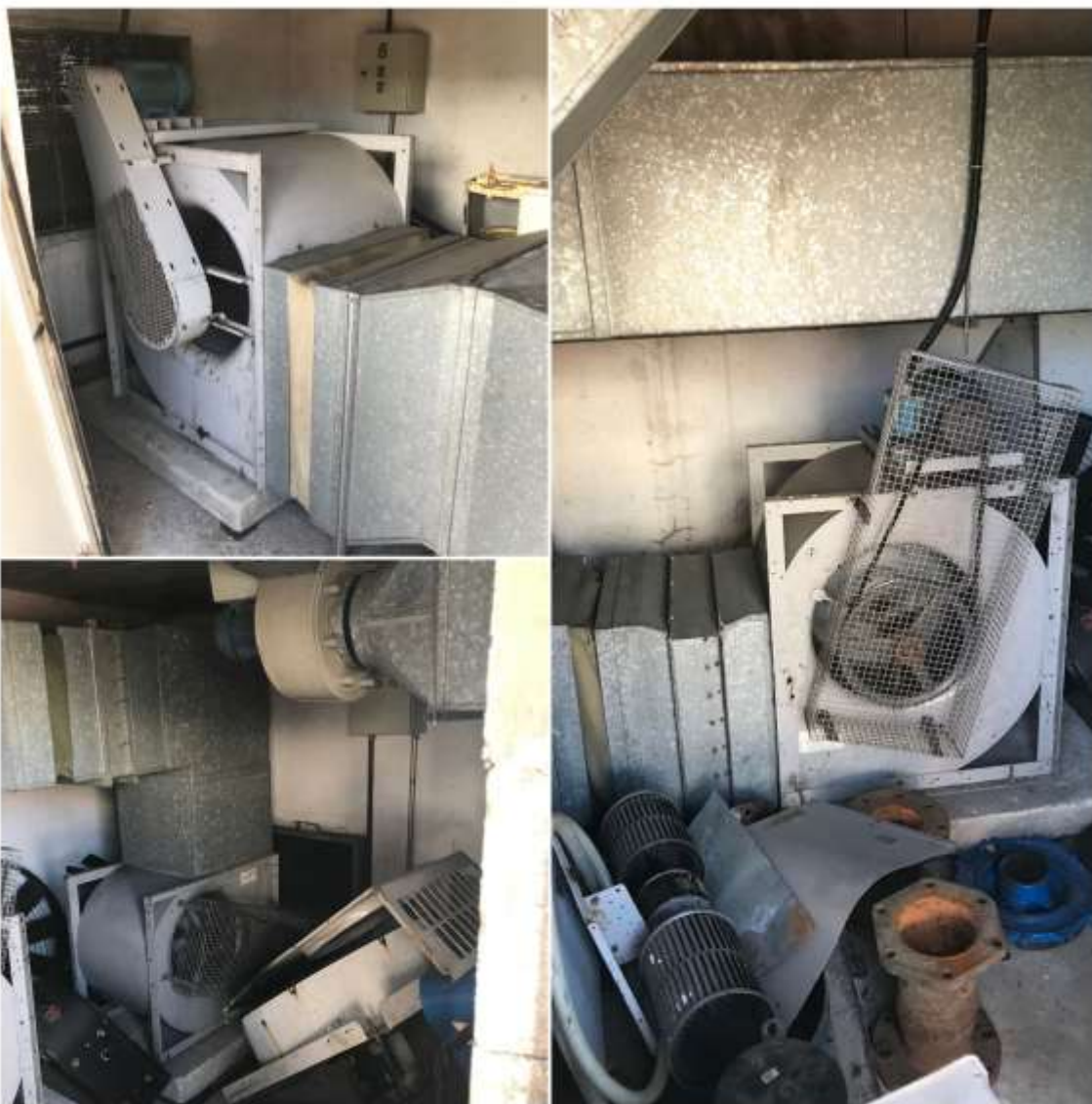
Figuras 17, 18 e 19 – Ventiladores/Exaustores
