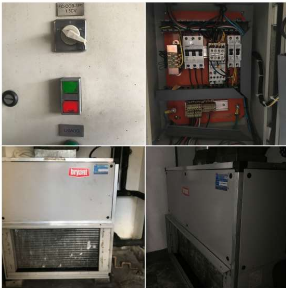
Figuras 13, 14, 15 e 16 – Fancoil / Quadro Elétrico
