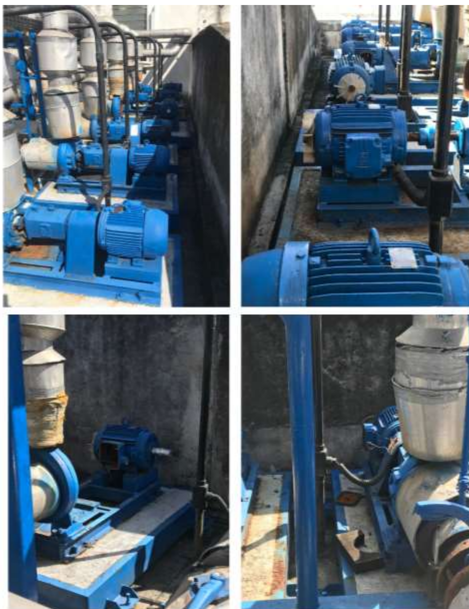
Figura 4, 5 , 6 e 7 – Bombas Primária e Secundária
