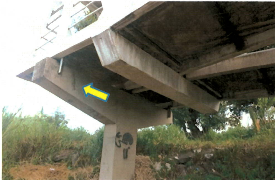
Figura 7 - Pilar P1 – Armadura exposta e em processo de corrosão.
