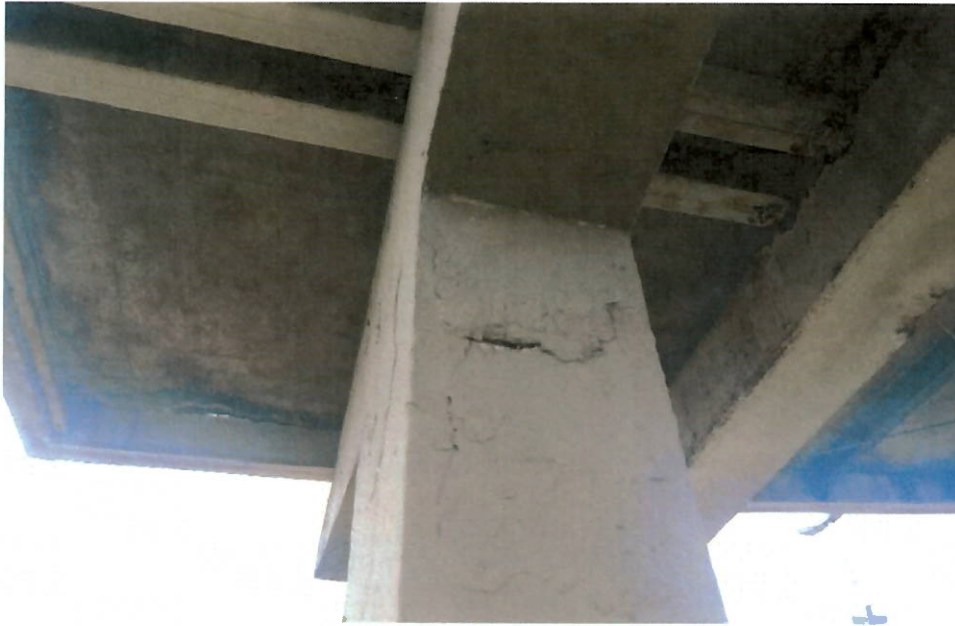
Figura 11 - Pilar P2 – Início de deslocamento de concreto e pontos com armaduras em processo de corrosão.
