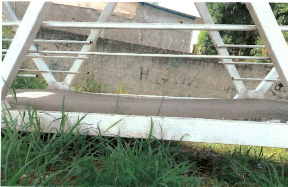
Figura 24 – Laje de Piso rampa de acesso 1 – Estrutura das placas de piso com grande deformação, e trecho sem barras de proteção
