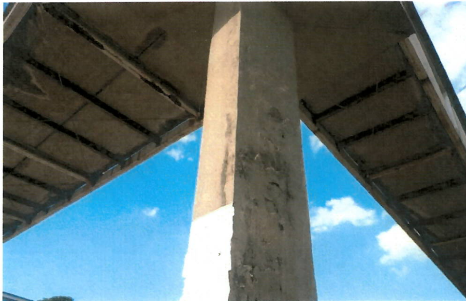
Figura 17 – Pilar P5 – Início de deslocamento de concreto e pontos com armaduras em processo de corrosão.
