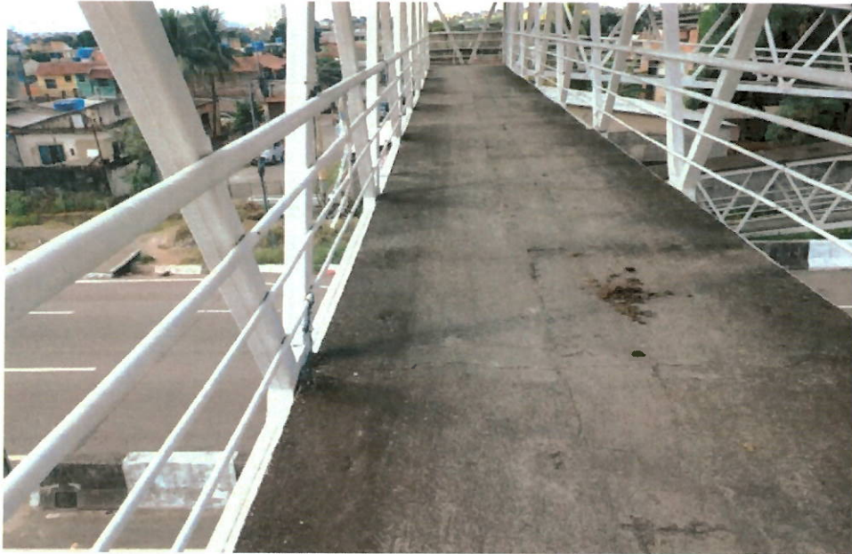
Figura 21 – Laje de Piso Travessia – Pontos com armaduras em processo de corrosão.
