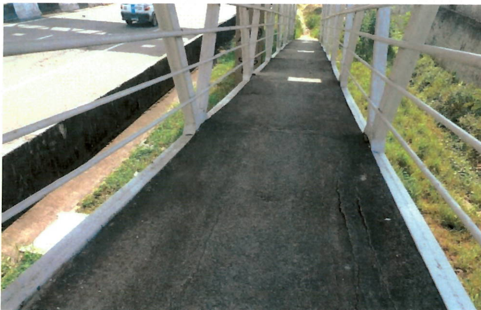
Figura 22 – Laje de Piso rampa de acesso 1 – Início de deslocamento de concreto e pontos com armaduras em processo de corrosão.
