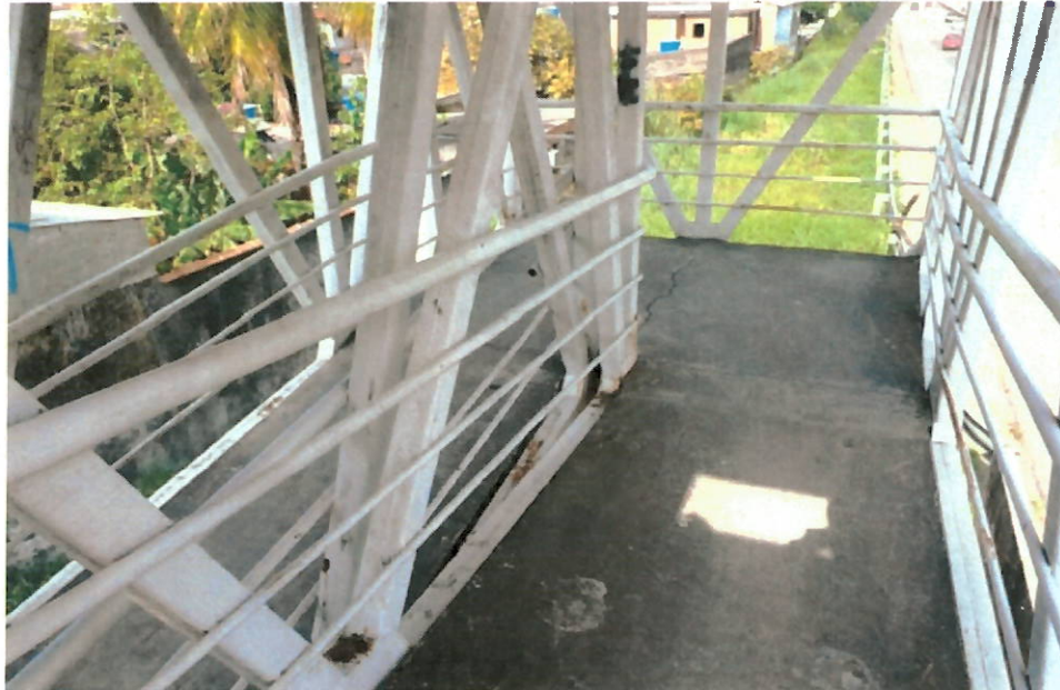
Figura 28 – Perfis em estado regular de conservação, com processo de oxidação e corrosão em alguns pontos
