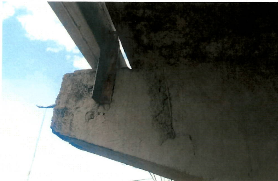
Figura 8 - Pilar P1 – Deslocamento de concreto e pontos com armaduras expostas e em processo de corrosão.
