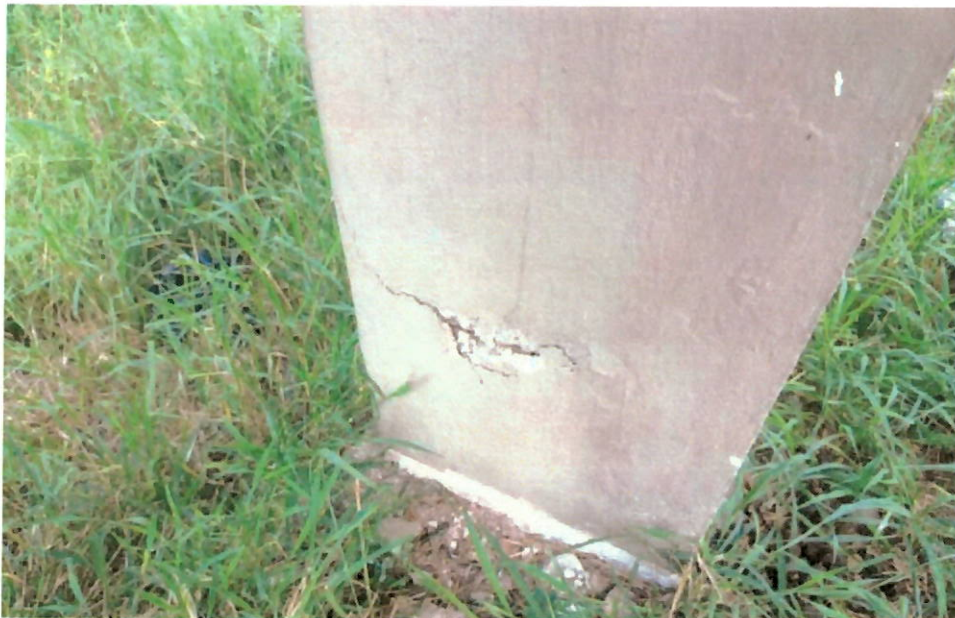
Figura 12 - Pilar P2 – Início de deslocamento de concreto e pontos com armaduras em processo de corrosão.
