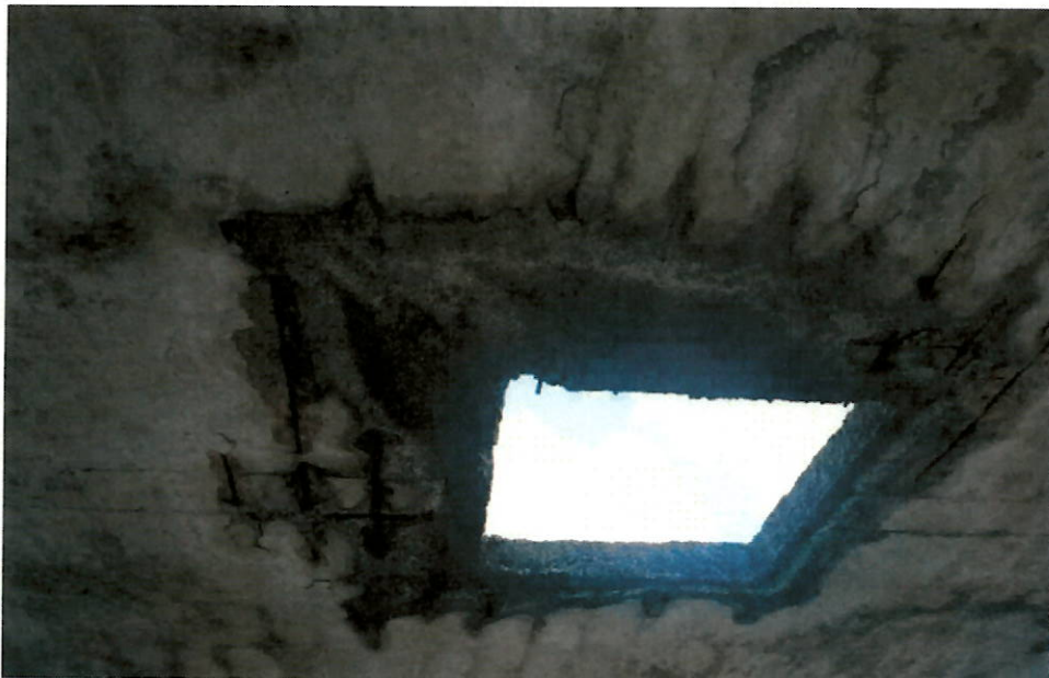
Figura 28 – Laje de Teto – Manchas em decorrência do escoamento de água, deslocamento de concreto e pontos com armaduras expostas e em processo de corrosão.
