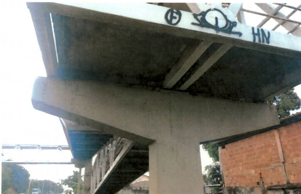
Figura 10 - Pilar P2 – Início de deslocamento de concreto e pontos com armaduras em processo de corrosão.
