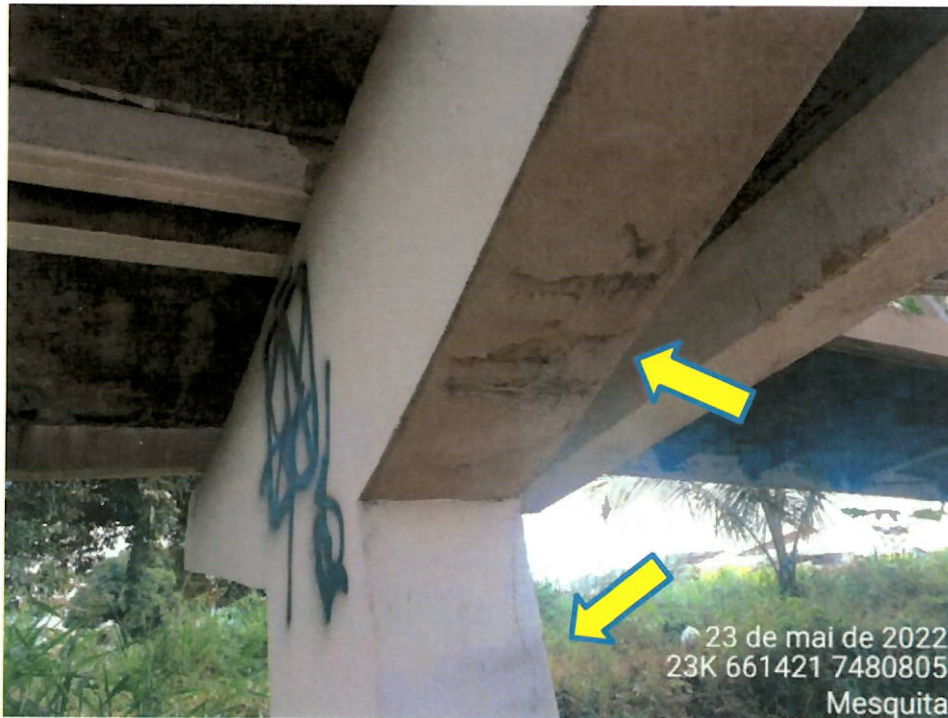
Figura 9 - Pilar P1 – Início de deslocamento de concreto e pontos com armaduras em processo de corrosão.
