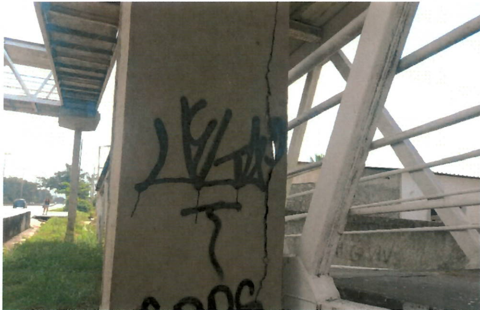
Figura 15 - Pilar P4 – Deslocamento de concreto e pontos com armaduras em processo de corrosão.
