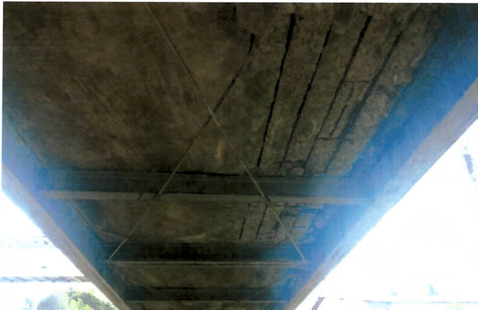
Figura 26 – Laje de Piso Rampa – Estrutura com trecho de ruptura da placa, perda de seção de concreto e trecho com armaduras expostas e em processo de corrosão.
