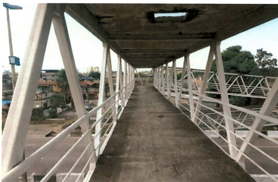
Figura 27 - Perfis em estado regular de conservação, com processo de oxidação e corrosão em alguns pontos
