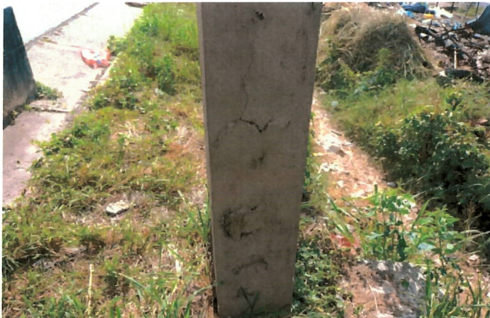
Figura 18 – Pilar P7 – Início de deslocamento de concreto e pontos com armaduras em processo de corrosão.
