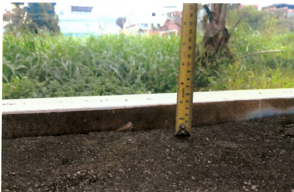
Figura 20 – Laje de Piso rampa de acesso 1 – Estrutura das placas de piso com grande deformação.
