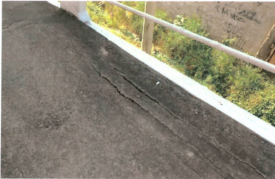
Figura 23 – Laje de Piso rampa de acesso 1 – Início de deslocamento de concreto e pontos com armaduras em processo de corrosão.
