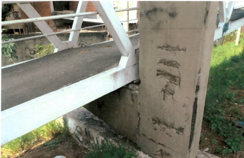
Figura 16 – Pilar P4 – Pontos com armaduras em processo de corrosão.
