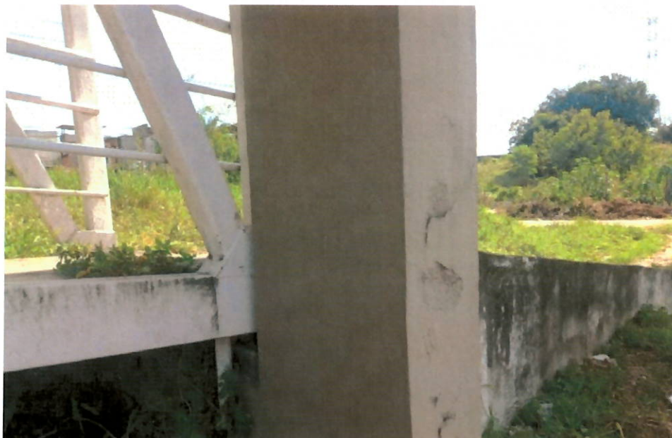
Figura 13 - Pilar P3 – Início de deslocamento de concreto e pontos com armaduras em processo de corrosão.
