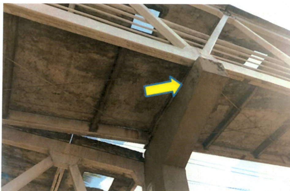
Figura 14 - Pilar P3 – Início de deslocamento de concreto e pontos com armaduras em processo de corrosão.
