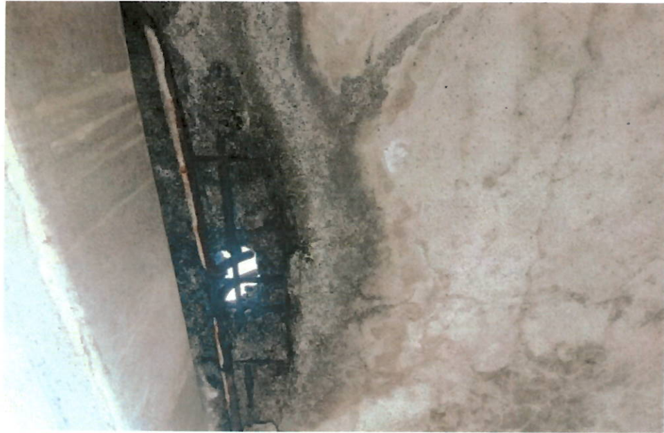
Figura 27 – Laje de Teto – Manchas em decorrência do escoamento de água, deslocamento de concreto e pontos com armaduras expostas e em processo de corrosão.
