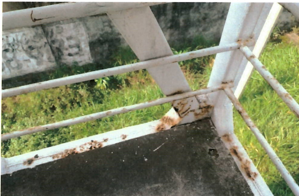
Figura 29 – Patamar Acesso 2 – Perfis em estado regular de conservação, com processo de oxidação e corrosão em alguns pontos
