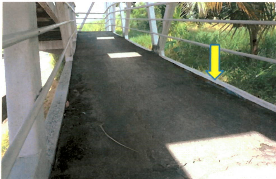
Figura 19 – Laje de Piso rampa de acesso 1 – Estrutura das placas de piso com grande deformação (linha de referência para identificar amplitudes da flecha).
