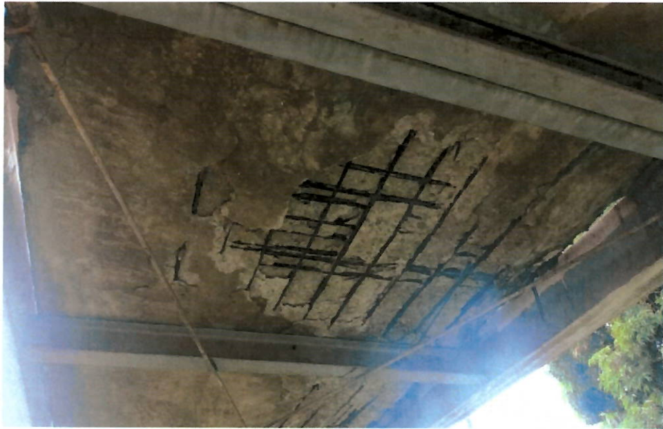
Figura 25 – Laje de Piso Rampa – Estrutura com trecho de ruptura da placa, perda de seção de concreto e trecho com armaduras expostas e em processo de corrosão.
