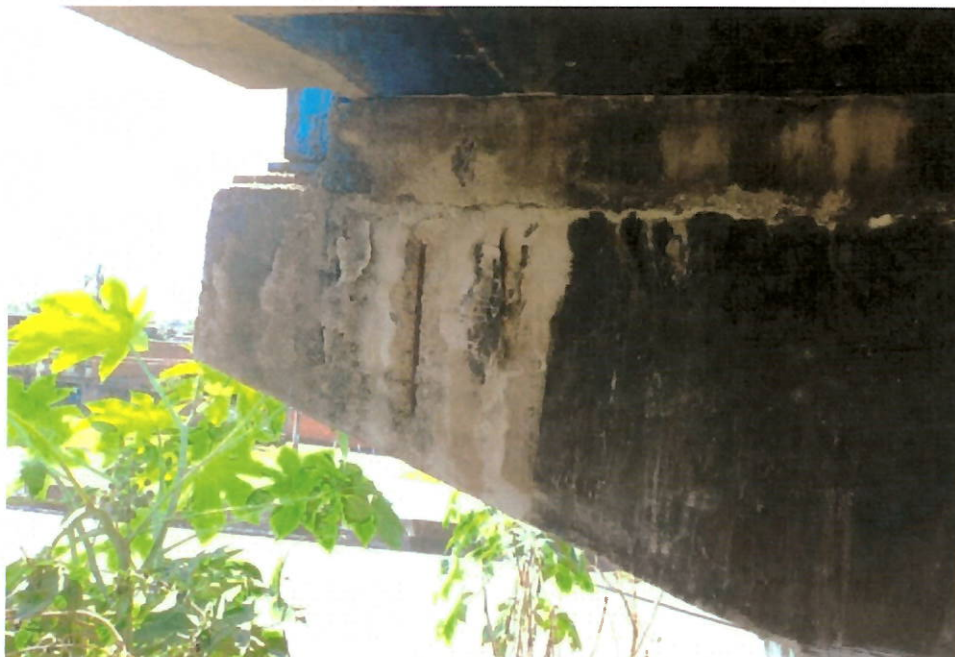
Figura 13 - Pilar P3 – Manchas em decorrência do escoamento de água, deslocamento de concreto e pontos com armaduras expostas e em processo de corrosão
