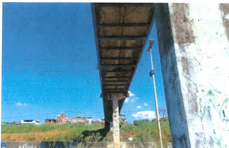
Figura 14 - Pilar P4 – Manchas em decorrência do escoamento de água.
