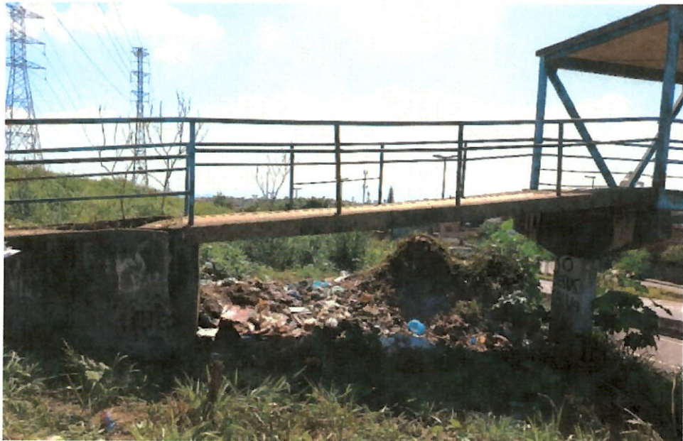
Figura 17 – Laje de Piso Acesso 1 – Trecho em Laje de concreto armado submetida a ação do fogo, causando calcinação do concreto.
