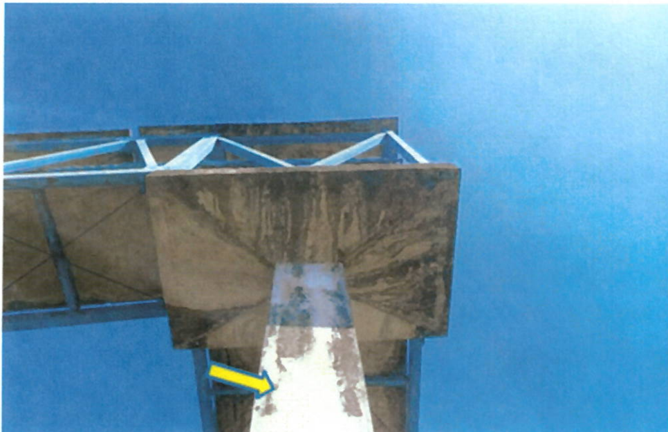
Figura 16 - Pilar P5 – Manchas em decorrência do escoamento de água, e fissura em decorrência da expansão aço causada pelo processo de corrosão em trechos onde houve reparo mal executado.
