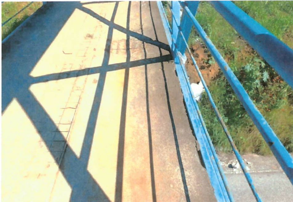
Figura 19 – Laje de Piso Travessia – Estrutura com trecho de ruptura da placa de piso, perda de seção de concreto e trecho com armaduras expostas e em processo de corrosão
