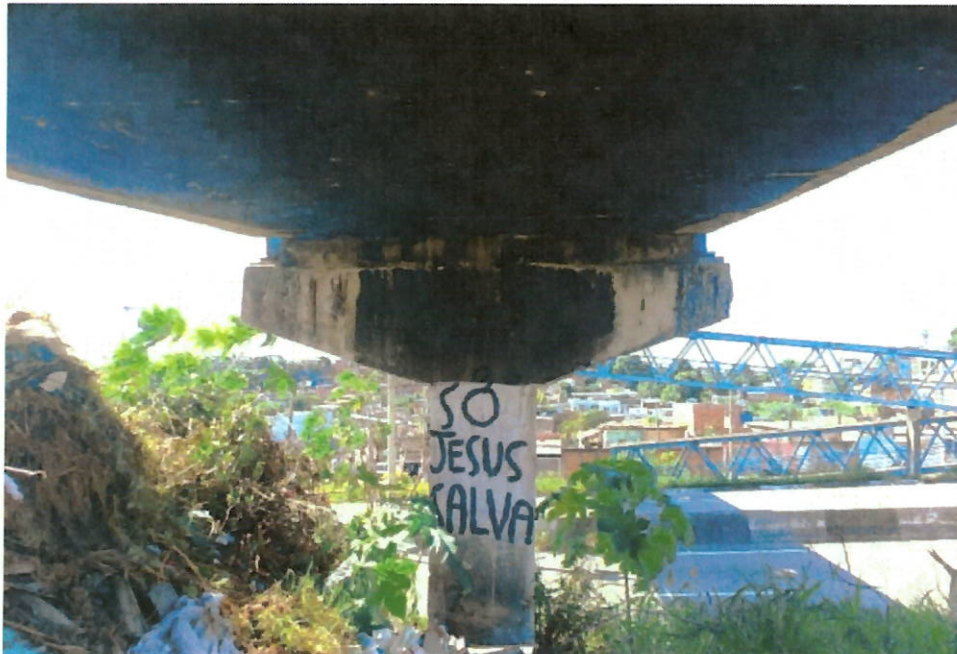
Figura 11 - Pilar P3 – Manchas em decorrência do escoamento de água, deslocamento de concreto e pontos com armaduras expostas e em processo de corrosão
