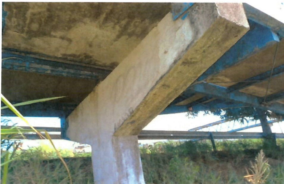
Figura 8 - Pilar P1 – Manchas em decorrência do escoamento de água e deslocamento de concreto
