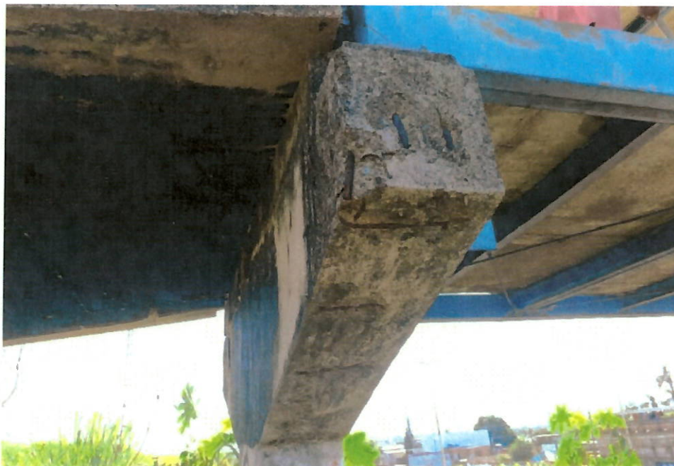
Figura 12 - Pilar P3 – Manchas em decorrência do escoamento de água, deslocamento de concreto e pontos com armaduras expostas e em processo de corrosão
