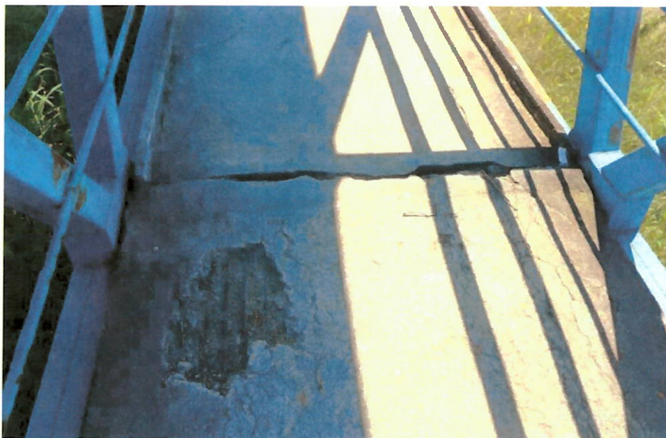
Figura 21 – Laje de Piso Acesso 2 – Estrutura com trecho de ruptura da placa de piso, perda de seção de concreto e trecho com armaduras expostas e em processo de corrosão
