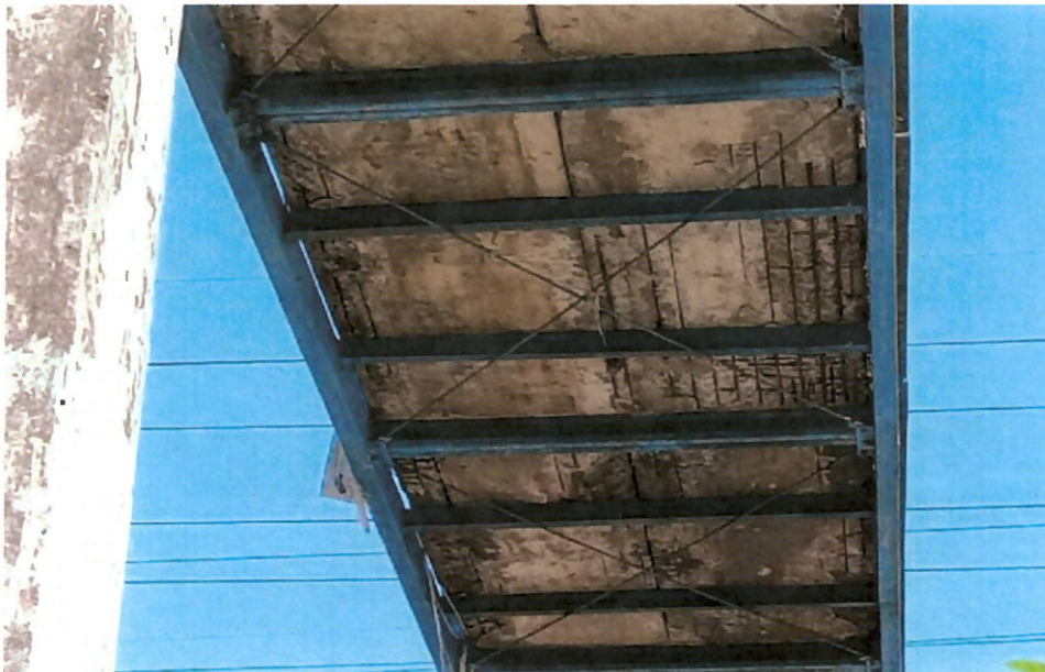
Figura 20 – Laje de Piso Travessia – Estrutura com trecho de ruptura da placa de piso, perda de seção de concreto e trecho com armaduras expostas e em processo de corrosão
