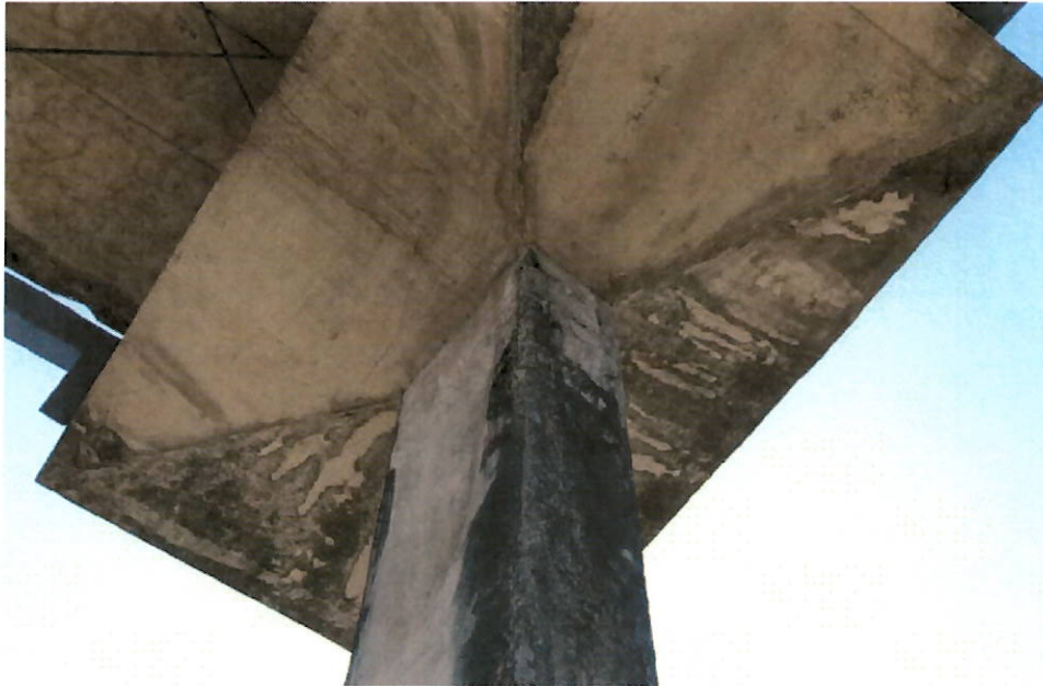
Figura 15 - Pilar P5 – Manchas em decorrência do escoamento de água.
