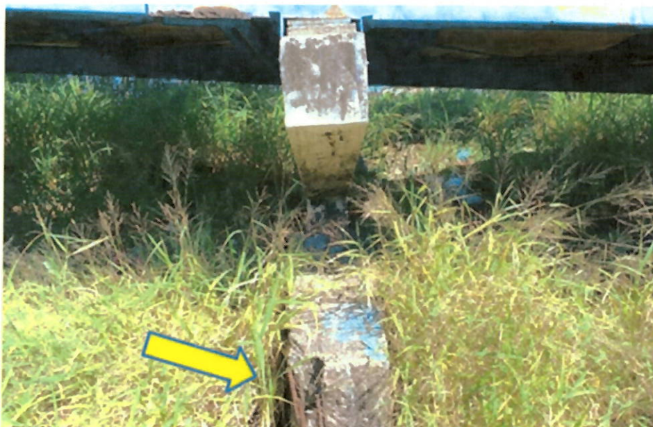
Figura 10 - Pilar P2 – Bloco de fundação com deslocamento de concreto e pontos com armaduras expostas e em processo de corrosão
