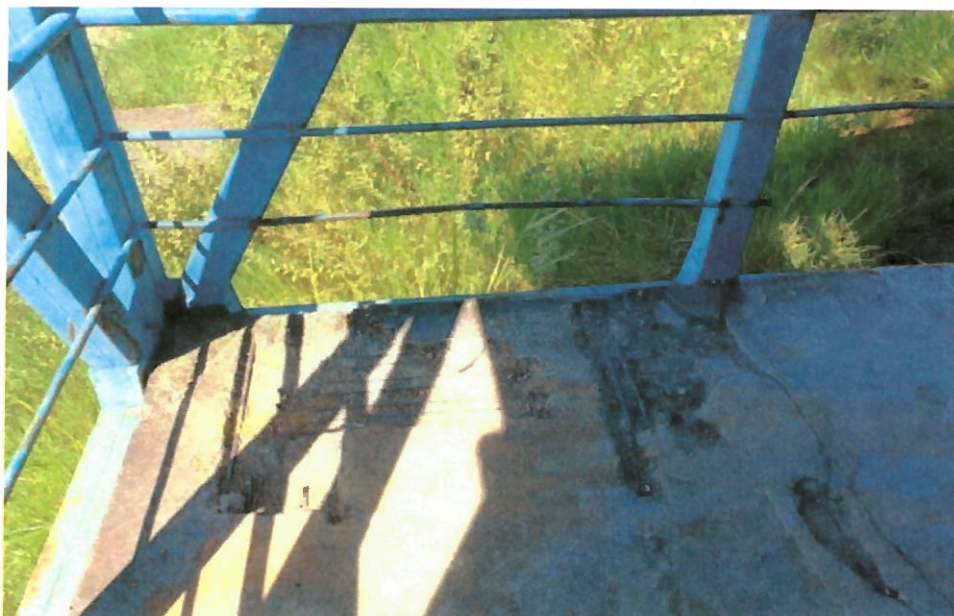
Figura 22 – Laje de Piso Acesso 2 – Estrutura com trecho de ruptura da placa de piso, perda de seção de concreto e trecho com armaduras expostas e em processo de corrosão
