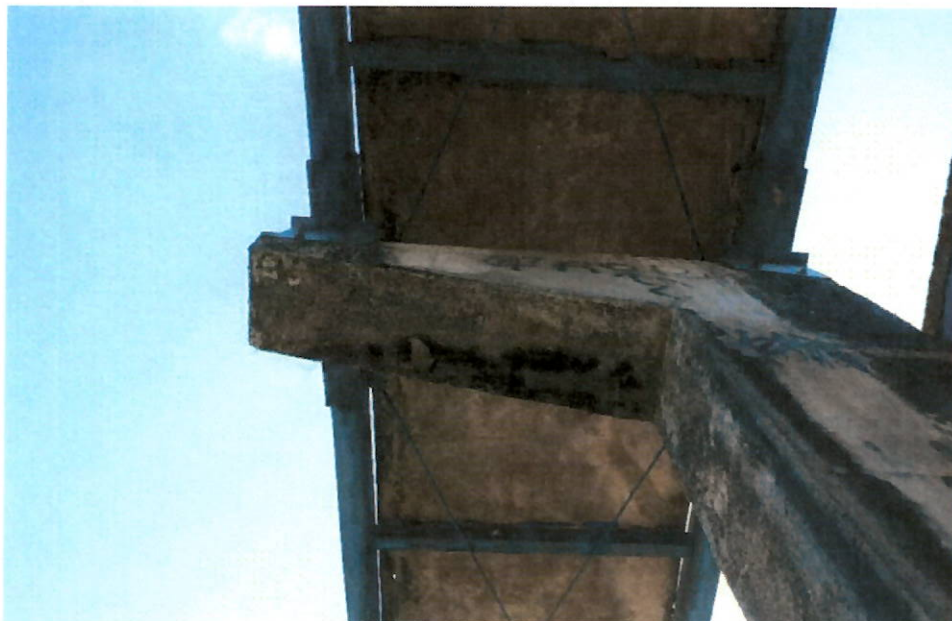
Figura 9 - Pilar P2 – Manchas em decorrência do escoamento de água.
