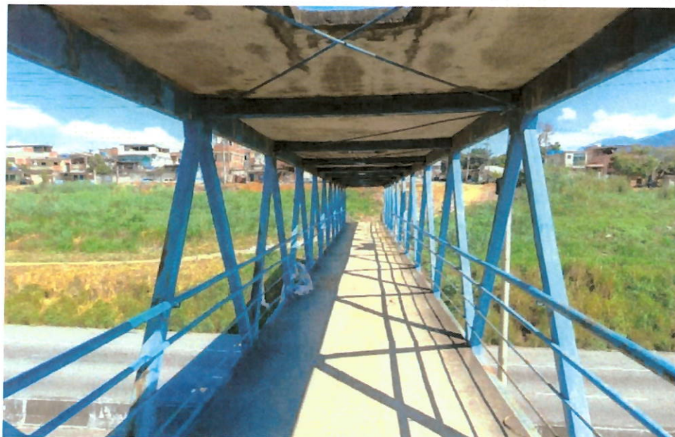
Figura 26 – Perfis do banzo superior em processo de oxidação.
