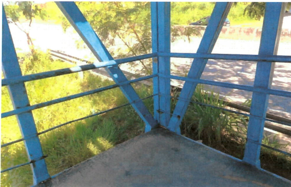
Figura 24 – Trechos com corrimão e guarda-corpo em processo de oxidação sem parte do guarda copo.
