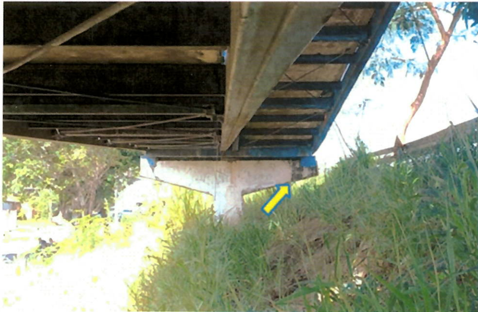
Figura 7 - Pilar P1 – Manchas em decorrência do escoamento de água.
